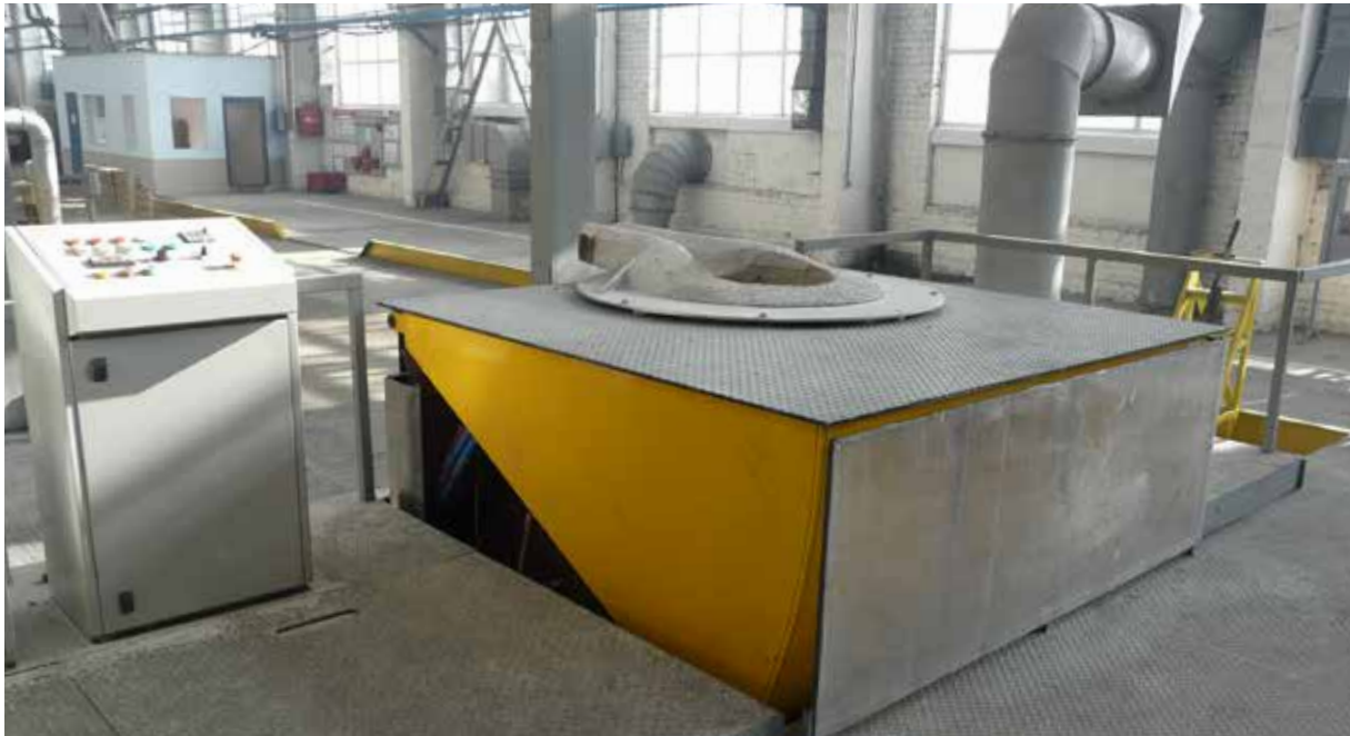
Un nuevo horno FIB de 1.200 kg de capacidad instalándose en una planta de fabricación de rodamientos.
