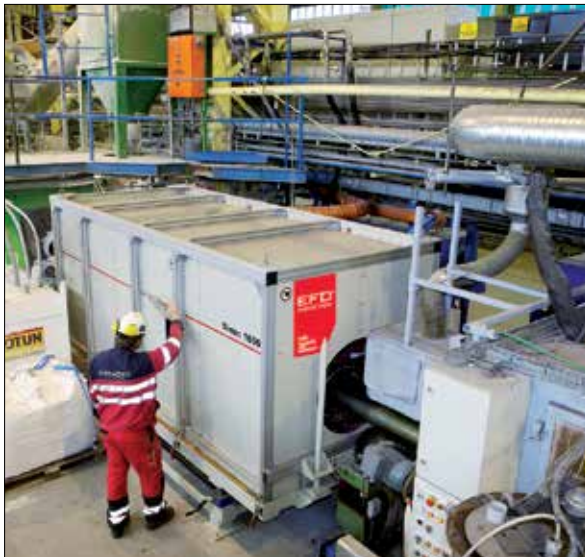
Un Sinac de moyenne fréquence compensé en série, en opération de préchauffage de composants industriels.
