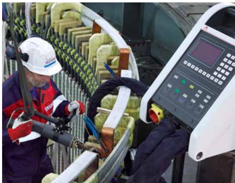
Un Minac de EFD Induction suelda los bobinados en generadores. La movilidad del Minac y del transformador porta-inductor permite a los operarios acceder a las zonas de más difícil acceso.
